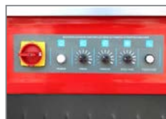
PANNELLO DI CONTROLLO CONTROL PANEL
