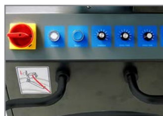
PANNELLO DI CONTROLLO CONTROL PANEL
