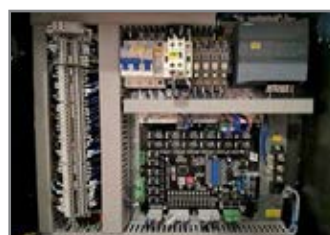
IMPIANTO ELETTRICO CON PLC SIEMENS MACHINE CONTROLLED BY SIEMENS PLC
